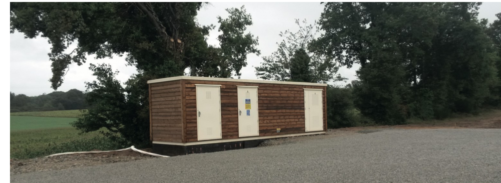
Illustration 11: Photographie d'un poste de livraison recouvert d'un bardage en bois
